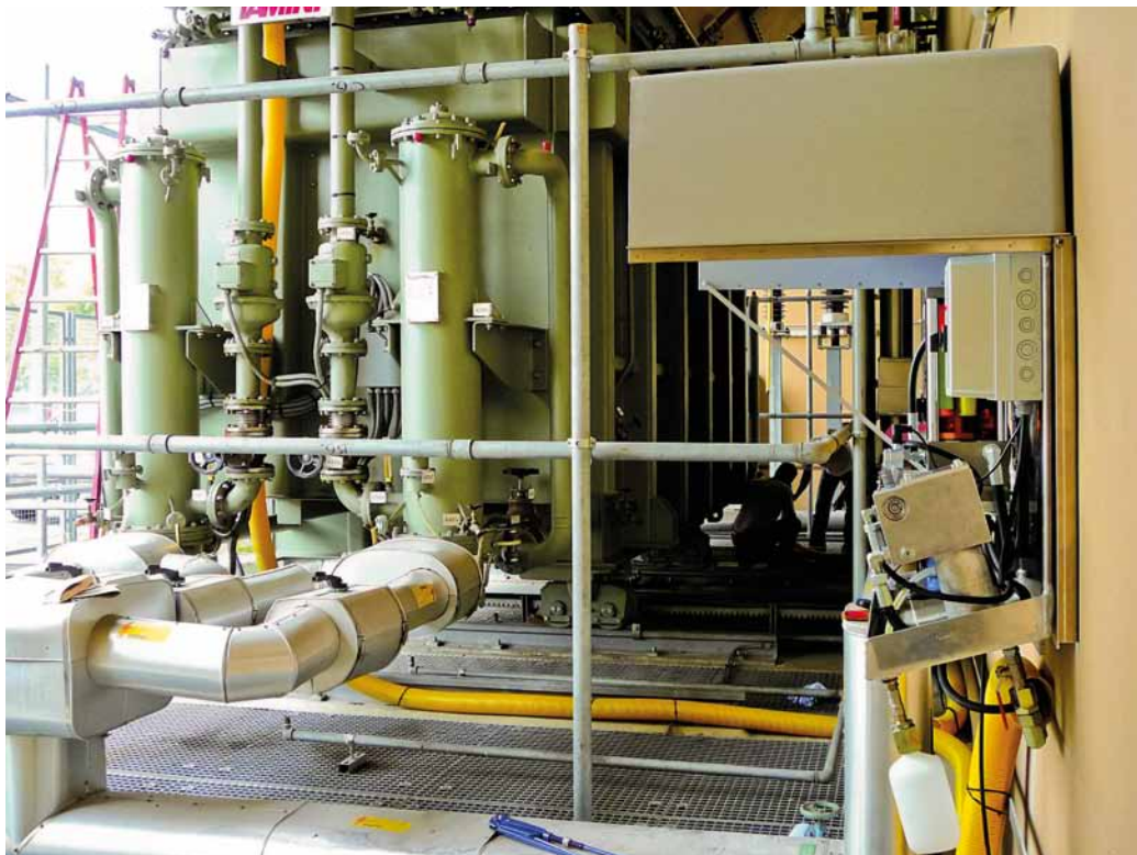
KUVA 3. Kuvan oikeassa reunassa muuntajaöljyn kunnossapito- ja kunnonvalvontayksikkö asennettuna.
